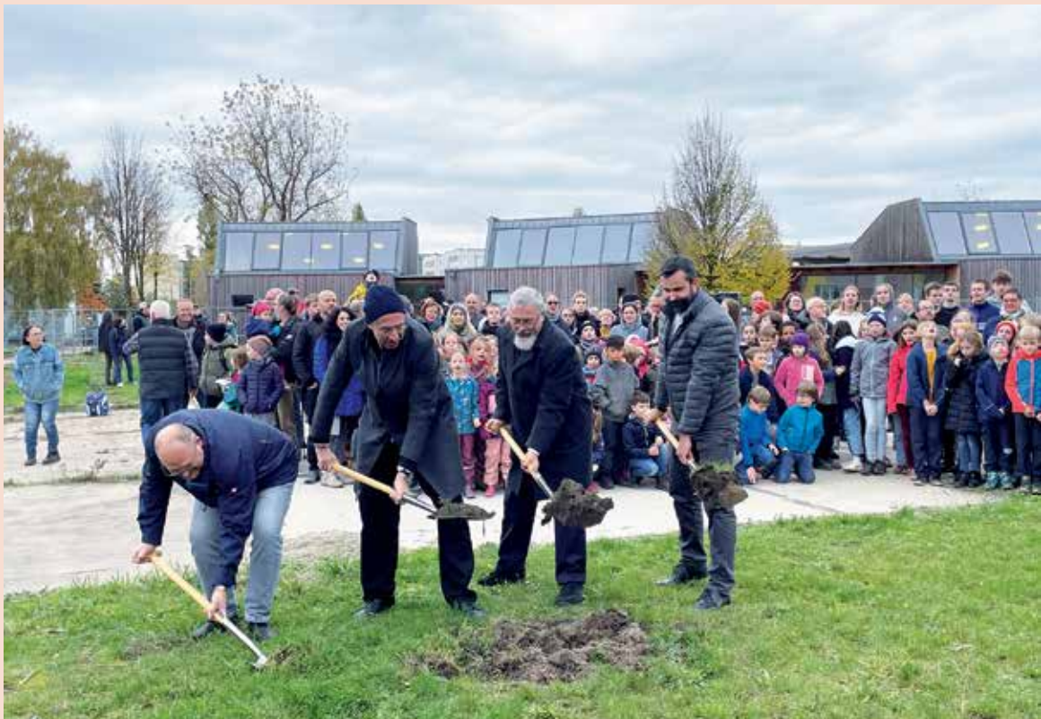
Am 03.11.23 fand auf dem Gelände der Freien Waldorfschule Magdeburg der feierliche Spatenstich für eine später als Mehrzweckgebäude zu nutzende Festhalle des Schulträgers statt.
